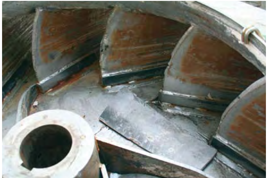
An diesem Lüftungsrad sind die deutlichen Verschleißspuren zu sehen. Nicht nur die einzelnen Schaufeln sind beschädigt, im Vordergrund ist sogar ein Teil abgebrochen.
